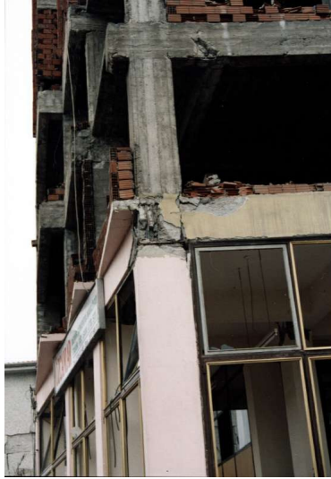
Figura 1.1: Daño en unión
