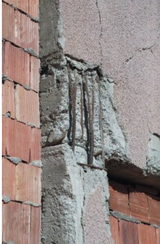
Figura 1.2: Nudo con salto de recubrimiento. Ausencia de refuerzos transversales en la unión
