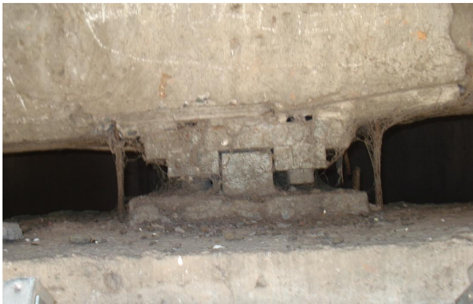
Figura 4.12. Guía de apoyo central en estribos y en pilas del puente P4.
