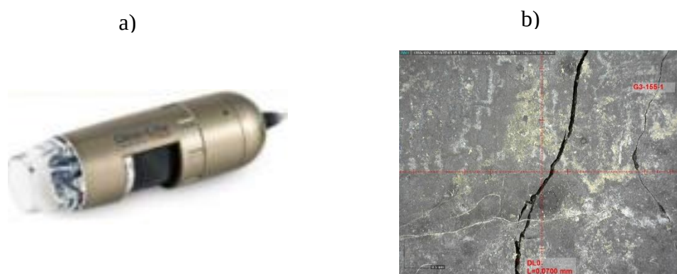
Figura 3.9: Medición de ancho de grietas por medio de un microscopio digital a) Microscopio digital empleado b) medición realizada con el microscopio digital.
