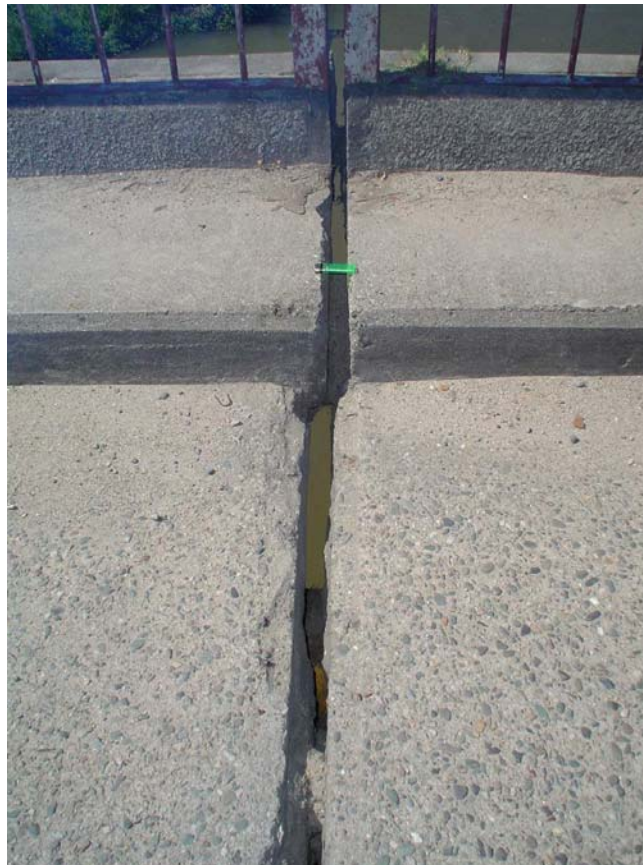
Fotografía 3.23: Descantillado de bordes de juntas
