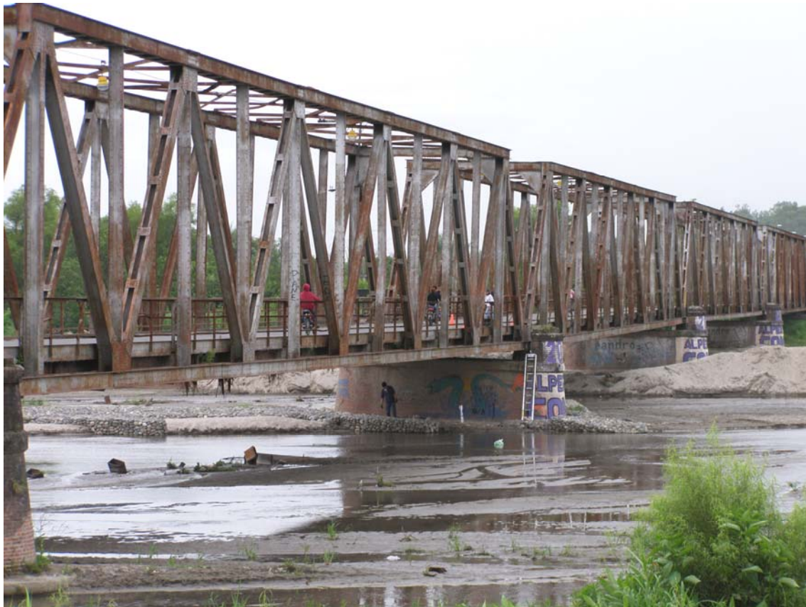
Fotografía 3.47: Rotación de la pila 2, vista aguas abajo
