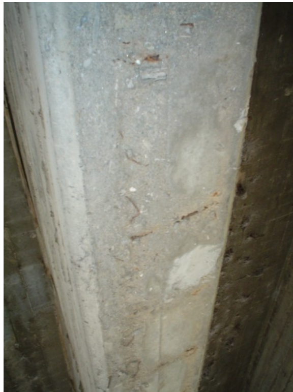
Fotografía 3.11: Escaso recubrimiento en fondo de viga.
