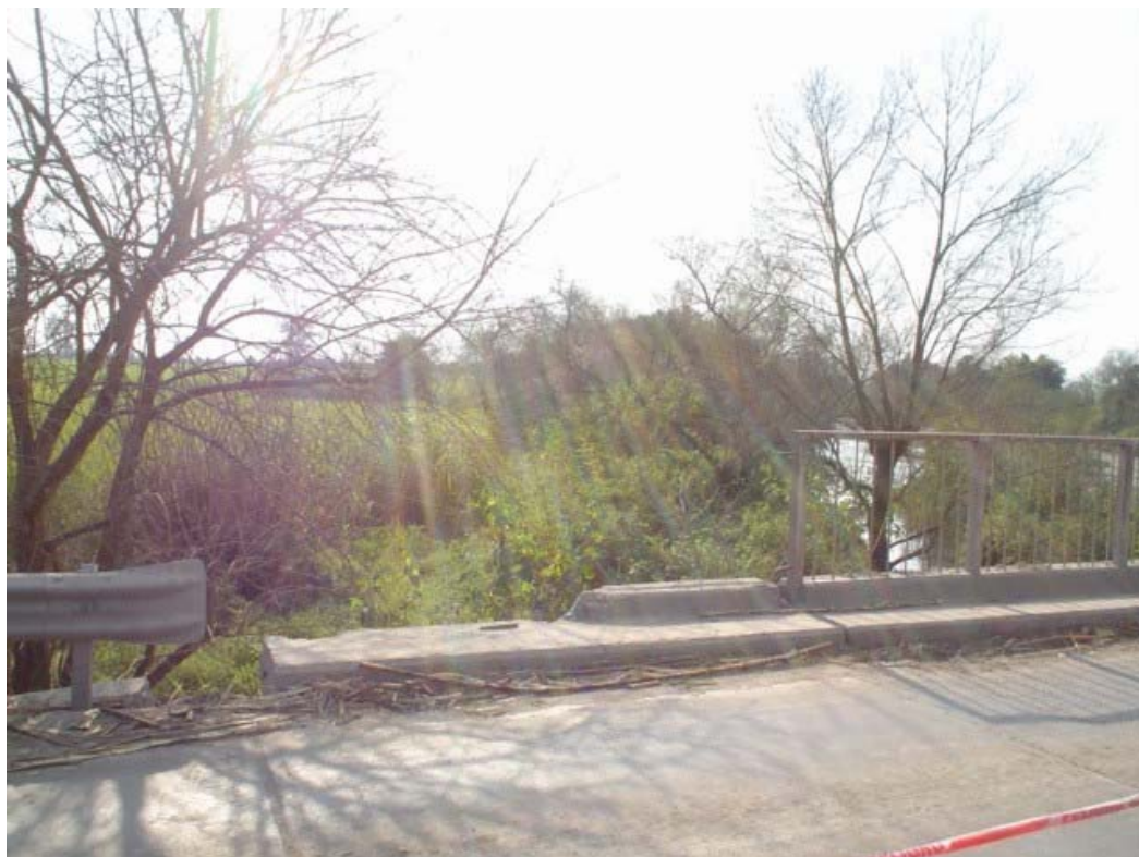
Fotografía 3.25: Faltante tramo de baranda en acceso
