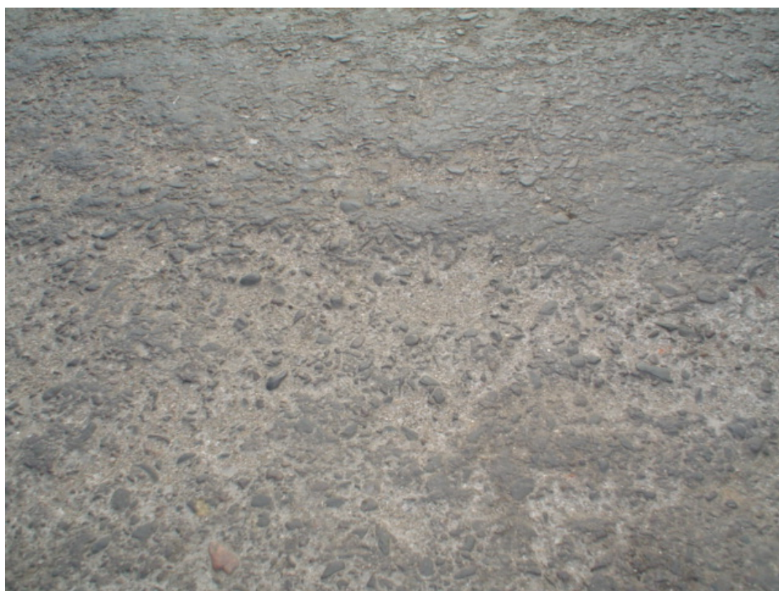
Fotografía 3.22: Desintegración progresiva de la superficie
