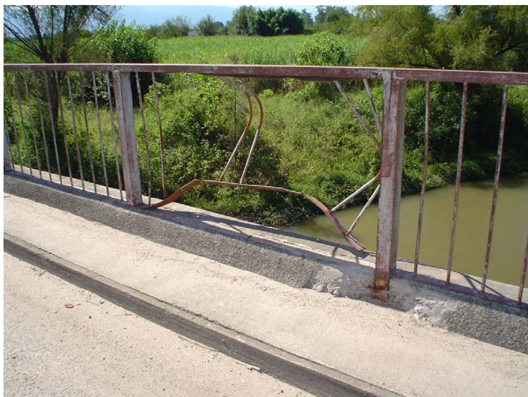
Fotografía 3.26: Baranda metálica dañada por impacto
