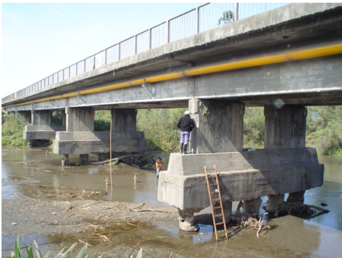
Fotografía 3.5: Erosión generalizada del lecho, socavación en pilas.
