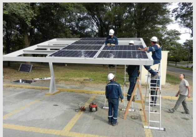
Techo fotovoltaico, ubicado en la FACET, Av. Independencia 1800 San Miguel de Tucumán, Tucumán, Argentina.
