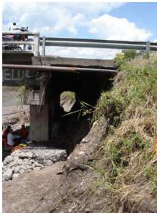
Fig. 1 Socavación de la cabecera del puente
