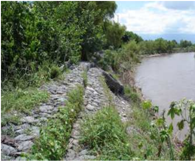
Fig. 2 Colapso de muro a lo largo de 25 m.
