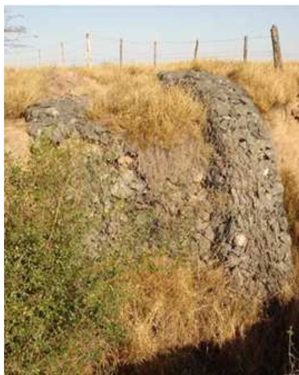
Fig. 24 Colchonetas tendidas sobre de un bordo. Este se escurrió y las colchonetas se hundieron.
