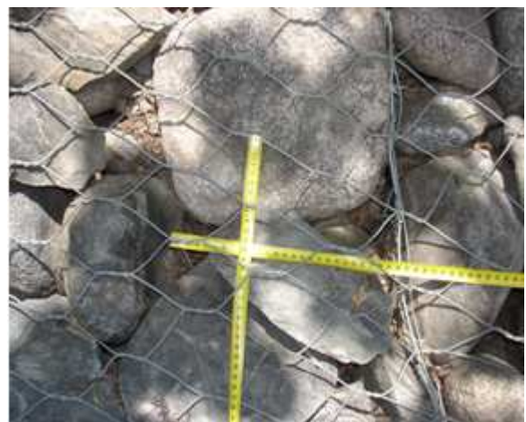
Fig. 5 Deformaciones longitudinales, transversales y tangenciales.
