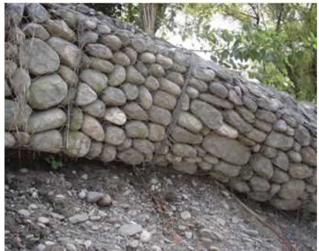
Fig. 4 Mallas con amplias deformaciones longitudinales, transversales y tangenciales.
