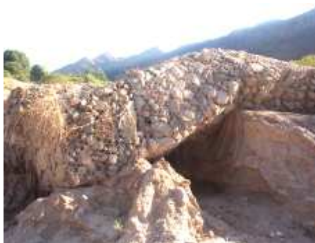
Fig. 22 Gavión volcado en el Badén de la Ruta provincial N° 11
