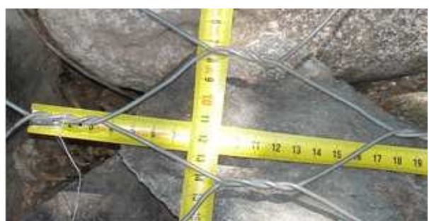
Fig. 6 Detalle de las deformaciones.
