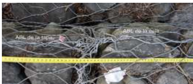
Fig. 15 Los alambres de borde no acompañan al alargamiento de la malla. ABL de la tapa y ABL de la caja.
