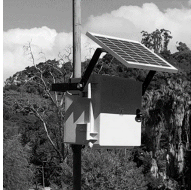
Figura 19. Conjunto panel solar y gabinete sujetado al mástil del CAPS los Bulacio.
